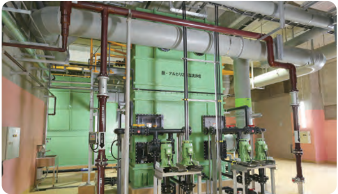
10 Torre de purificação de ácido e hipoclorito alcalino
