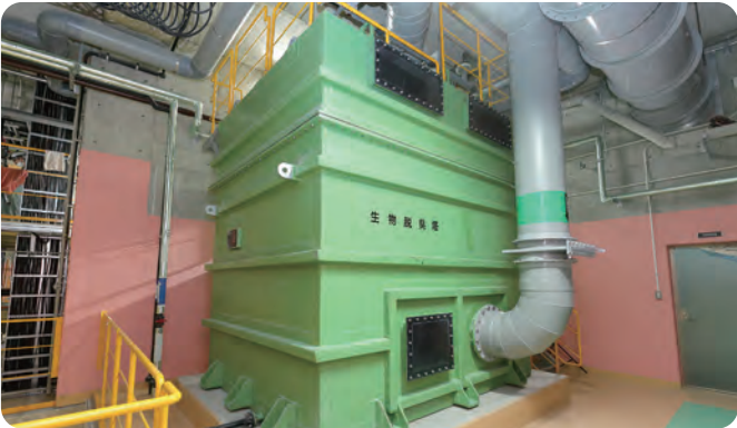
9 Torre de desodorização biológica
