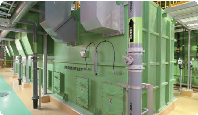
11 Torre de adsorção do carvão ativado de uso para média concentração
