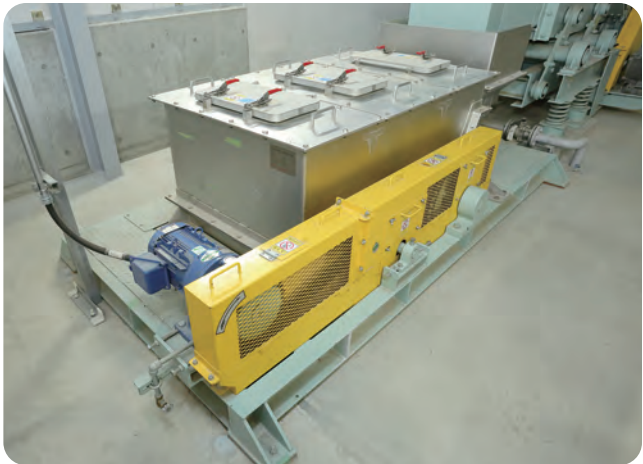
4 Separador magnético de metales fundidos El material fundido transportado desde el dispositivo de enfriamiento de escoria/metal se separa mediante un separador magnético en escoria y metal, y se envía a sus respectivos depósitos para su almacenamiento.
