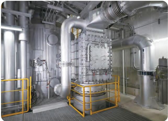
5 Cámara de combustión El gas generado por el horno de gasificación y fusión se quema completamente en la cámara de combustión y se envía a la caldera a 850°C.
