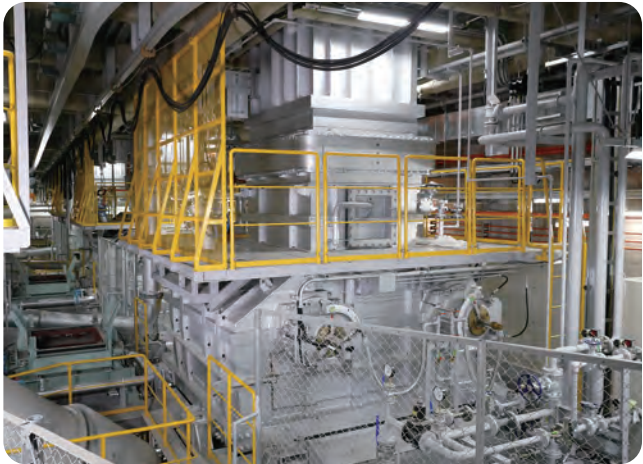
3 Horno de fusión y gasificación Dentro del horno de gasificación y fusión la basura es derretida a una temperatura alta de 1.700 a 1.800°C y se reciclan en escoria y metal. En Hiroshima Central Ecopark se puede tratar hasta 285 toneladas de basura al día.
