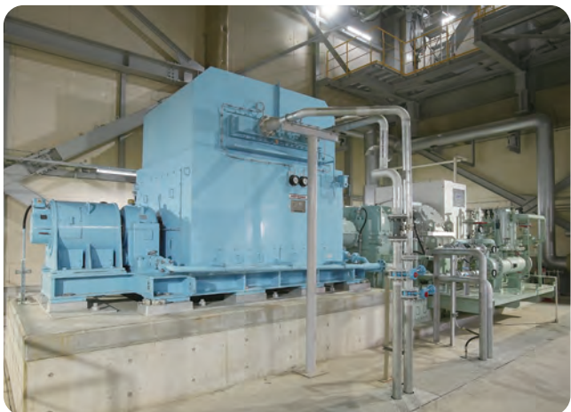
9 Generador eléctrico por turbina de vapor Utiliza el vapor producido por la caldera y genera hasta 6.500 kW. Se utiliza en la planta y el excedente de electricidad se vende.
