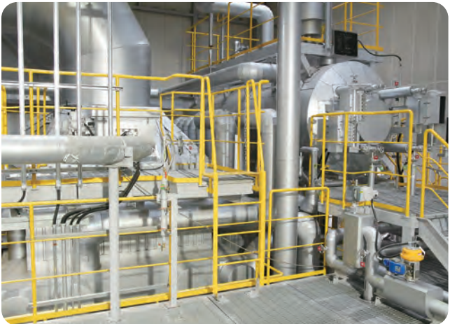
6 Caldera Se recupera la energía térmica generada al tratar la basura, se produce vapor, y se envía a un generador de turbina de vapor.
