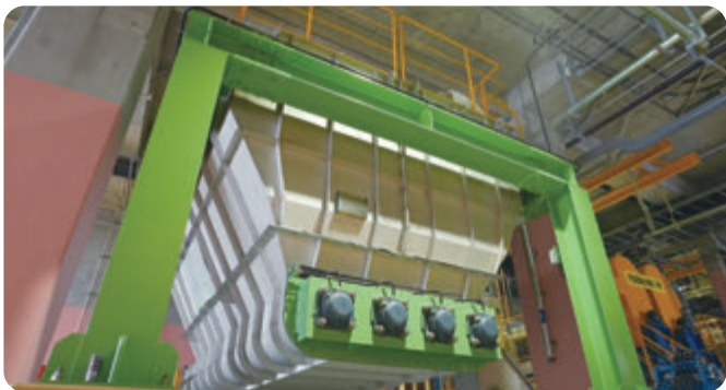
5 助燃剂储存装置
