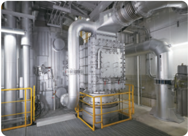
5 燃烧室 气化熔融炉产生的气体在燃烧室内完全燃烧后, 以850摄氏度送至锅炉。
