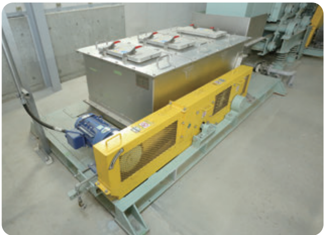
4 熔融金属磁选机 从炉渣金属冷却装置中搬运出来的熔融物经由磁选机分离成矿渣和金属后, 被分别送至不同料场储存。
