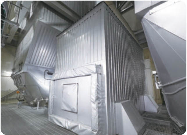
8 催化反应塔 过滤式集尘器排出的废气中所含的有害氮氧化物与催化剂反应分解成氮和水, 同时仅剩的少量二恶英类也会无害化。
