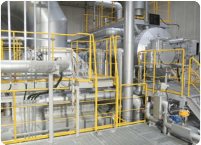
6 锅炉 回收处理垃圾时产生的热能, 并通过高温形成高压蒸汽。
