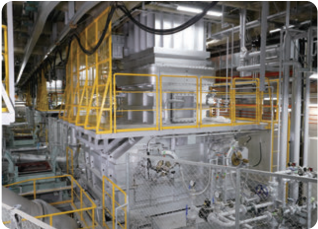
3 气化熔融炉 入炉的垃圾在气化熔融炉中1700~1800摄氏度的高温下被熔化, 作为炉渣和金属再资源化。广岛中央生态公园每天最多可处理 285 吨垃圾。
