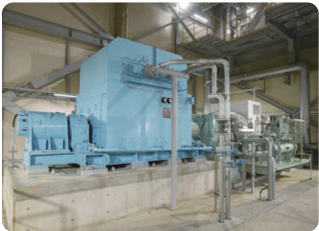
9 汽轮发电机 利用锅炉产生的蒸汽发电, 最大可达6500千瓦。除了被用于设施内, 剩余电力将被出售。
